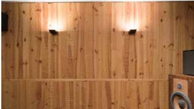
部屋の両サイドには、ローゼンクランツ特製の音響パネルを設置。高さは上が1680mmで下が840mmと倍音の構成になっていて、上下の間と床との接合部には幅木を配してある。オクターブ和音で構成された各パネルが運動調和し、音楽エネルギーとしてリスナーの方向に流れるように工夫が施されている
