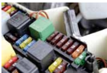
ヒューズボックスの中から1個1個のヒューズを見極め、同じアンペアどうしを入れ替えたり、逆向きとなっているヒューズの向きを正しくすると「足まわりがよくなってしっかりしました」と語る益野さん
