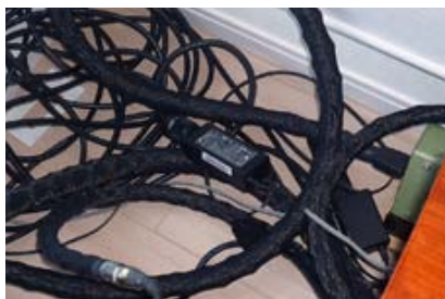
元々の電源の取り方。全く整理がされておらず、これでは高価なケーブルもその真価を発揮できない。
